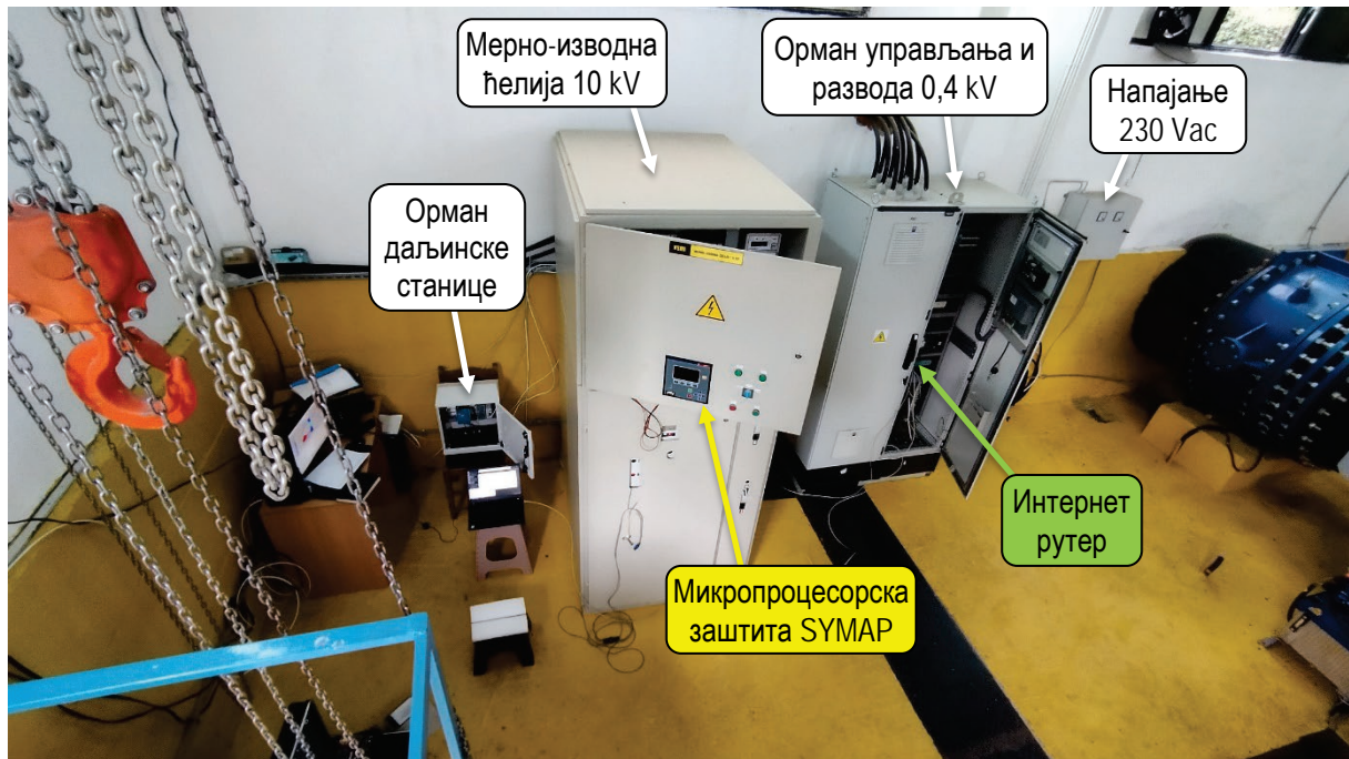
Слика 3 Имплементација даљинске станице на објекту
