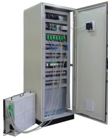
Slika 3 - Izgled (sa zadnje strane) i način povezivanja ormara turbinske regulacije (desno) i hardverskog simulatora (levo)
