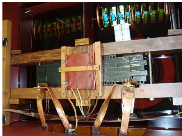
Sl.15. Način montaže i mesto ugradnje mernog elektronskog modula za merenje napona i struje ESI-pogled sa gornje strane transformatorskog suda
