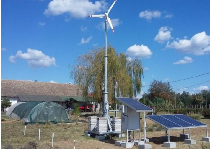
Slika 1: Hibridni sistem snabdevanja energijom kogeneracijom energije sunca i vetra (originalno tehničko rešenje: Institut „Mihajlo Pupin“ d.o.o. Beograd)
