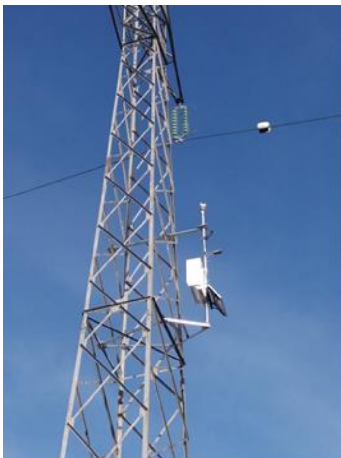
Слика 3 – Инсталирана метеоролошка станица на стубу далековода и – ОТЛМ сензорска јединица на проводнику
