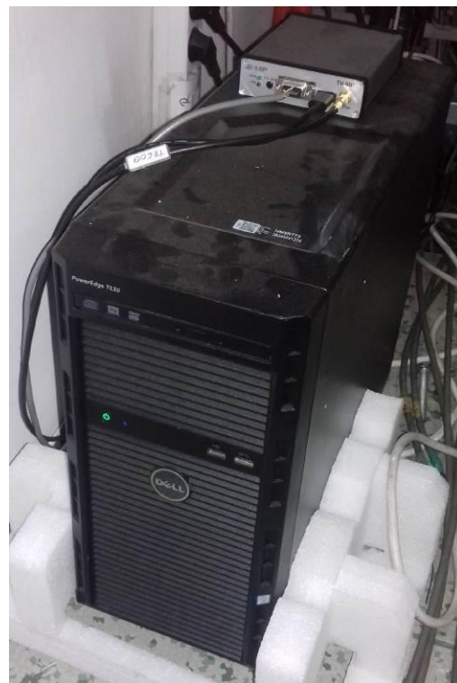
Слика 2 Пример реализације резервног Stratum 1 сервера са GNSS пријемником
