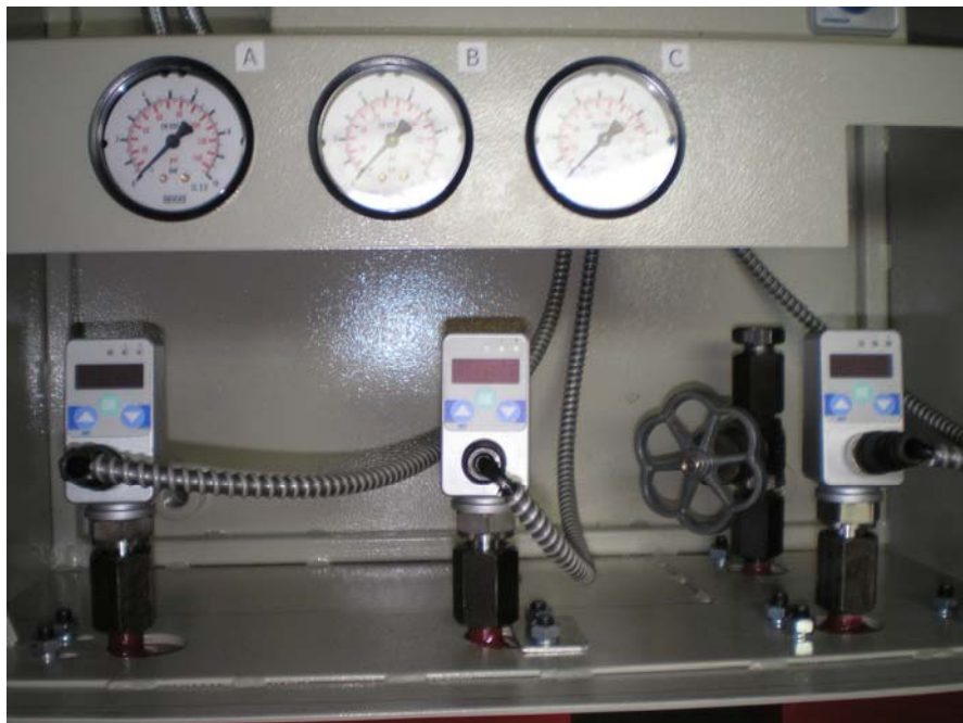
Sl.11. Izgled i montaža manomaetara A,B,C i elektronskih presostata EP1,EP2,EP3
